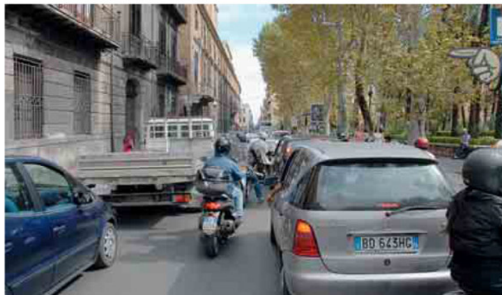
A. F. LA PARALISI DEL TRAFFICO IN CORSO VITTORIO EMANUELE IN PROSSIMITÀ DELLA CATTEDRALE PER I LAVORI DI RIFACIMENTO DELL'ASFALTO
