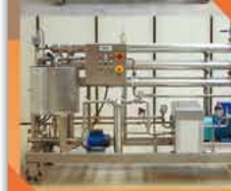
Impianto per osmosi inversa e nanofiltrazione
