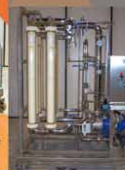
Impianto di filtrazione tangenziale realizzato sia con membrane ceramiche che con membrane in polisulfone
